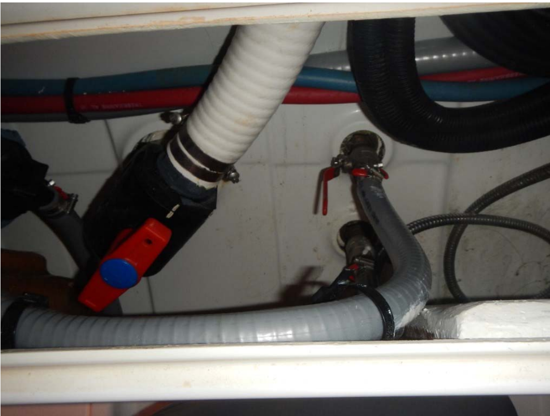
10-Scarico Wc Beneteau
