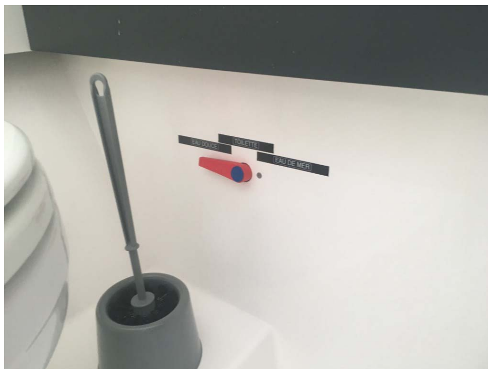
6-Valvola a 3Vie per scarico Wc-Cantiere RM-RM 1370
